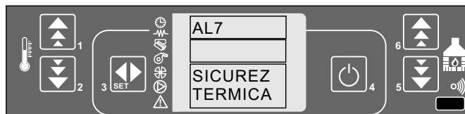
pannello comandi - allarme termostato generale
