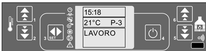
pannello comandi - condizione di lavoro
